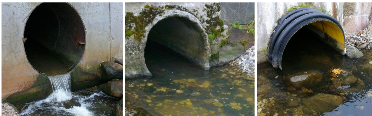
Joonis 13. Saare tee sademevee kollektori väljalask (vasakpoolne foto; kaardil nr. 1), Russalka sademe- ja drenaazivee väljalask (keskmine foto; kaardil nr. 3) ja Kadrioru sademevee väljalask (parempoolne foto; kaardil nr. 4). Fotod on tehtud proovide kogumise ajal 27.09.2016.
