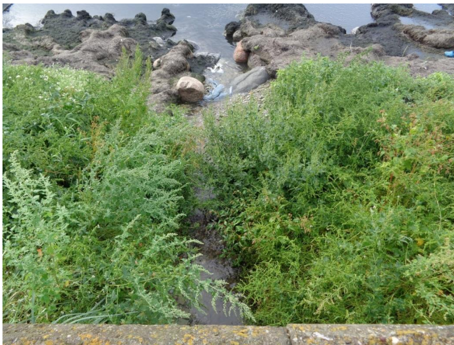
Joonis 21. 2017. aasta juulil Pirita tee ääres Näituseväljaku kõrval asuva kõrghoone ees üle betoonbarjääri tehtud foto merre suubuva (solgi)toru väljavoolust ja kohtumiskohast merega.
